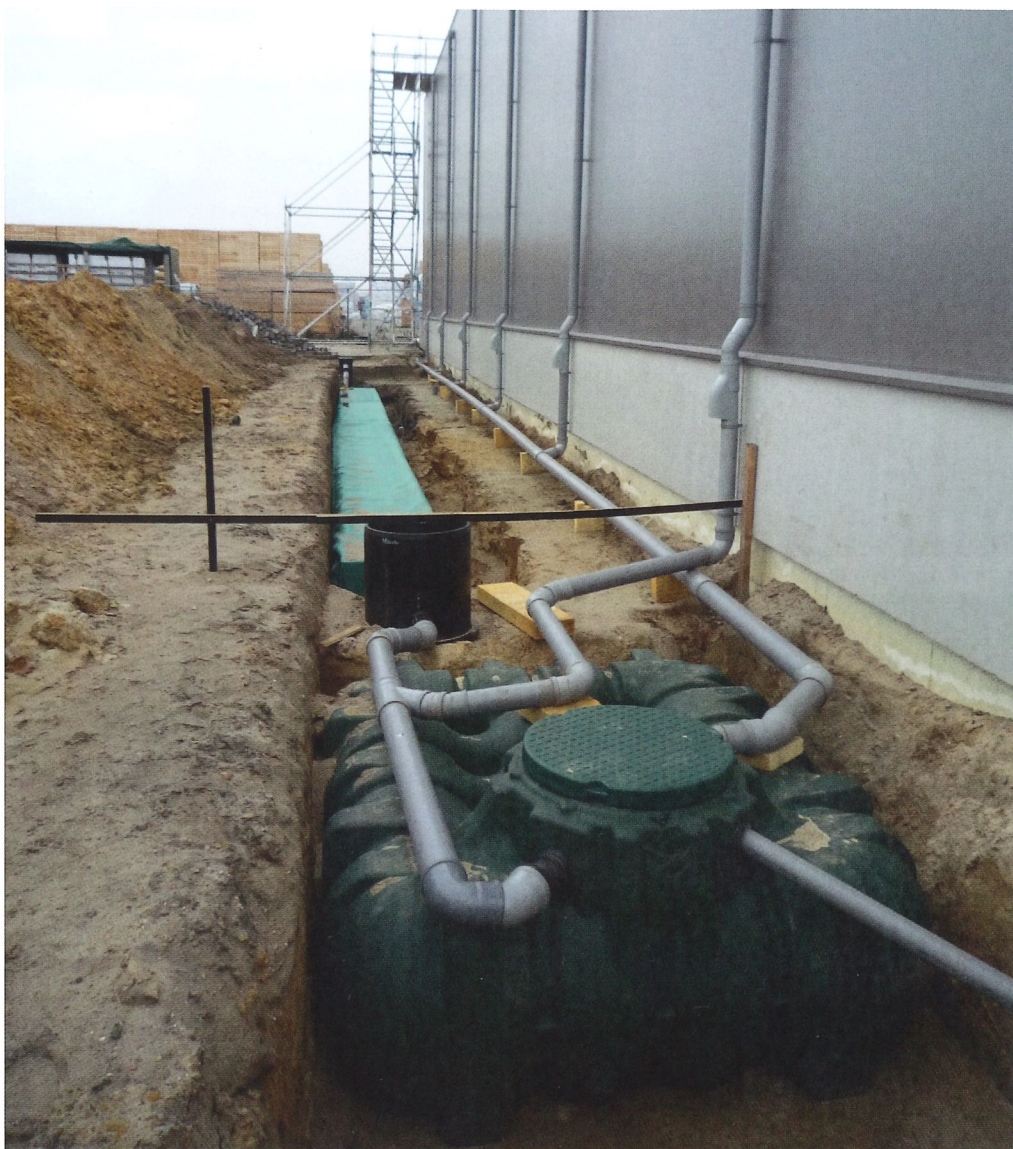
Hemelwater wordt opgeslagen in een tank, gefilterd en gebruikt voor toiletspoeling.
